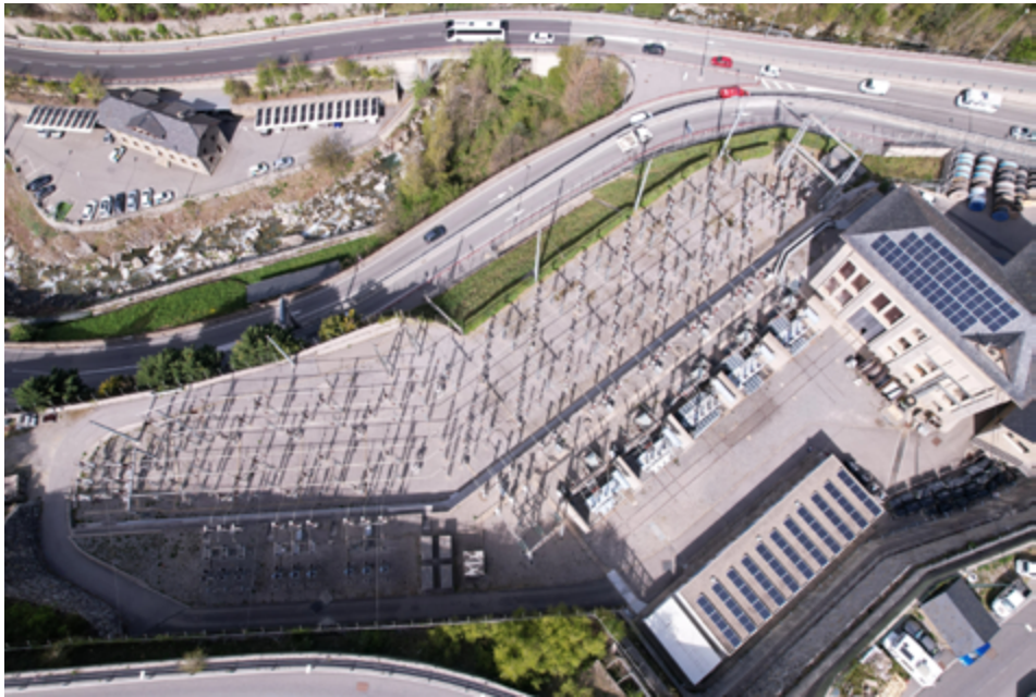
Instal·lacions fotovoltaïques a l'ETR d'Encamp.
