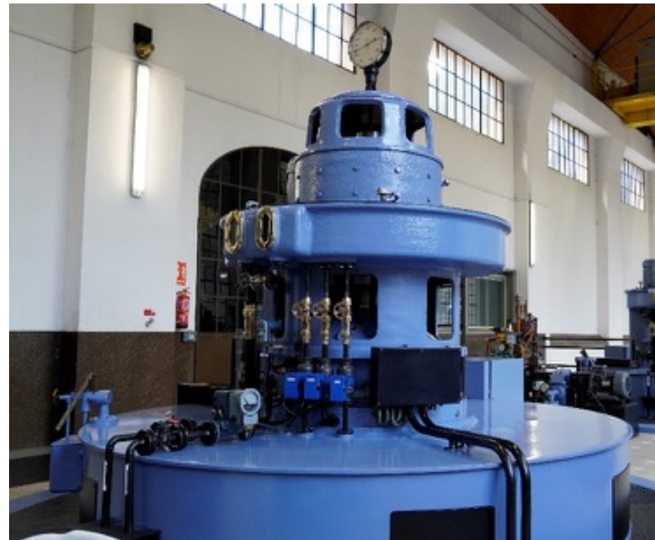
Grup hidroelèctric 1, després del gran manteniment.
