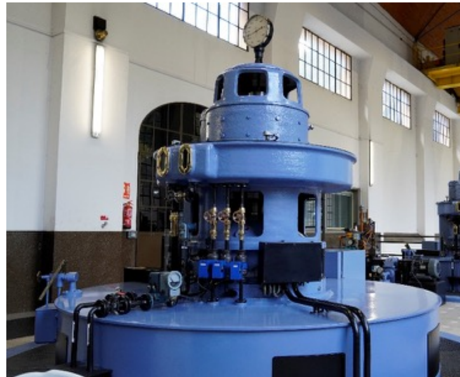
Grup hidroelèctric 1, després del gran manteniment.
